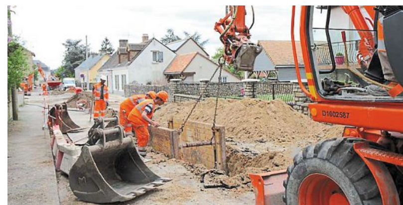
Rue Lucien-Corbin, on profite du réaménagement du centre-bourg pour enfouir tous les réseaux.
